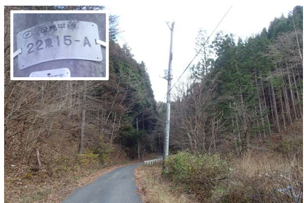
発電所候補地最寄りの高圧配電柱(笹見平線22東15-A)。
