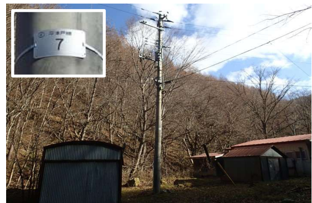
発電所候補地最寄りの高圧配電柱(平津戸線7)。
