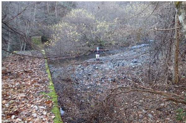
堰堤堆砂状況(満砂)。
