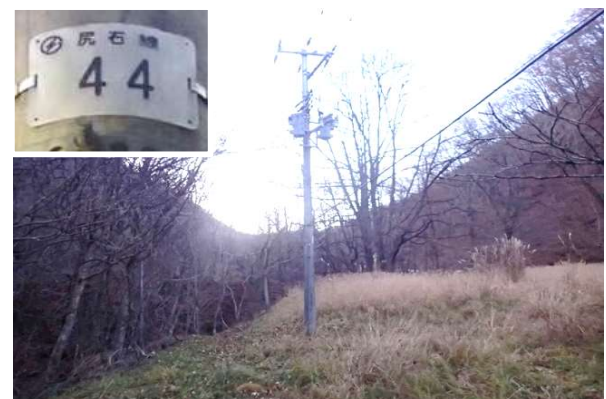
発電所候補地最寄りの高圧配電柱(尻石線44)。
