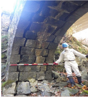
水路橋の老朽化状況(右岸側)
