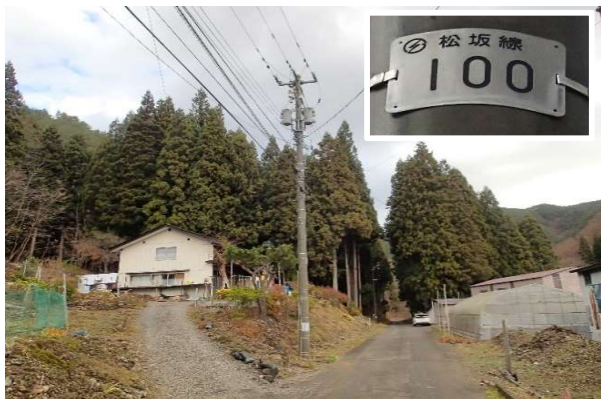
発電所候補地最寄りの高圧配電柱(松坂線100)。
