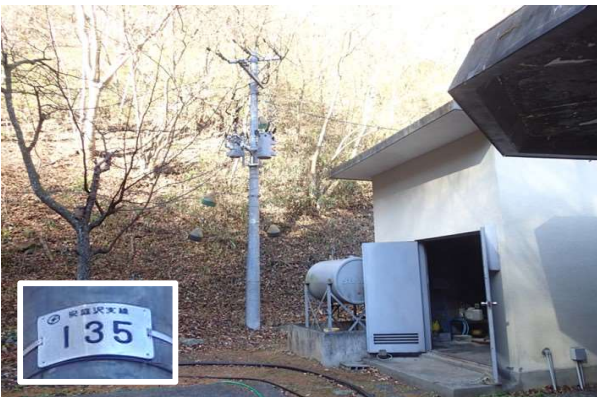
発電所候補地最寄りの高圧配電柱(安庭沢支線135)。
