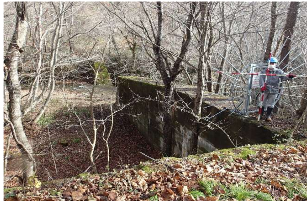
砂防えん堤堆砂状況(満砂)。
