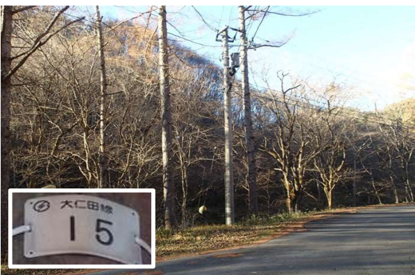
発電所候補地最寄りの高圧配電柱(大仁田線15)。
