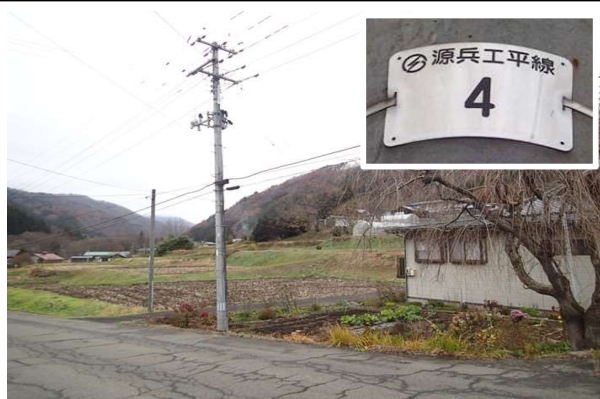
発電候補地最寄りの高圧配電柱(源兵工平線4)。
