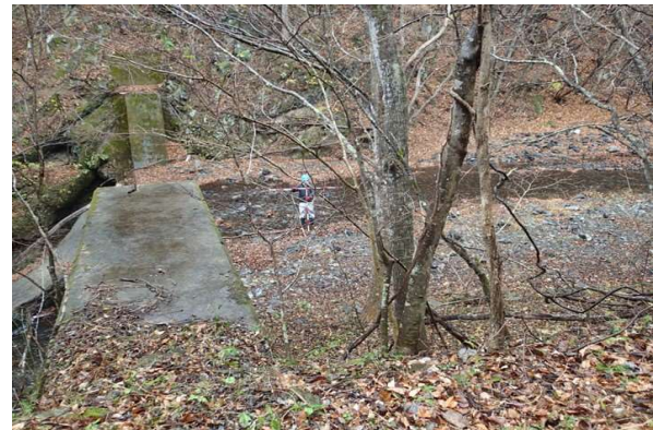
堰堤堆砂状況(満砂)。
