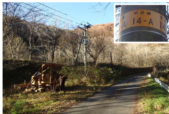
発電所候補地最寄りの高圧配電柱(平沢線14-A)。
