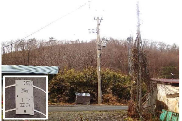
発電候補地最寄りの高圧配電柱(NTT東17左3)。
