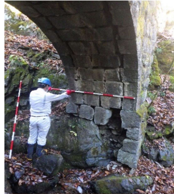
水路橋の老朽化状況(左岸側)
