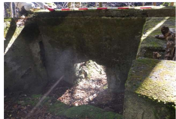
水圧管路入口
