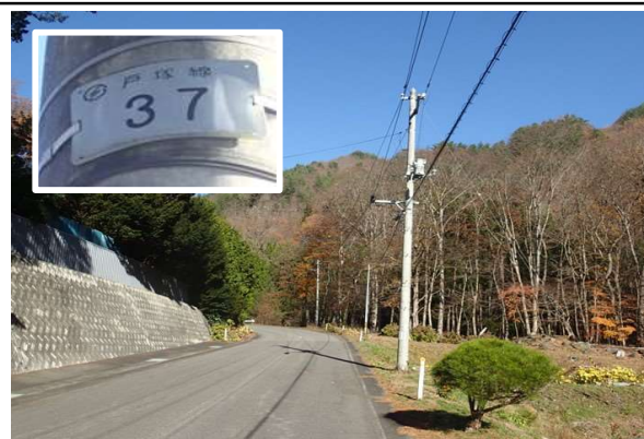
発電所候補地最寄りの高圧配電柱(戸塚線37)。
