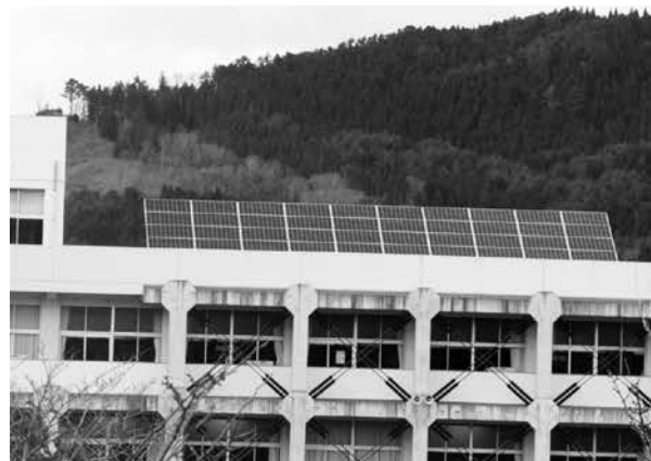
令和元年度に太陽光発電システムを設置した第一中学校
