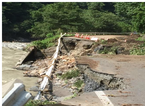
平成28年8月台風10号 (江繋)道路崩落
