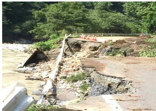
平成28年8月 台風10号 道路崩落(江繋)
