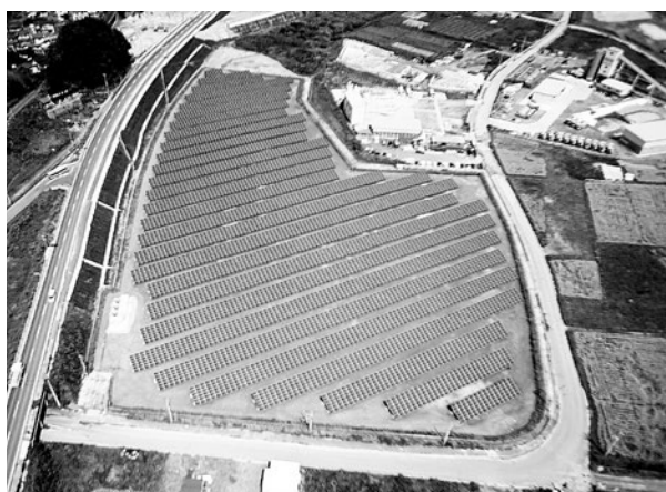
メガソーラー（田老発電所）
