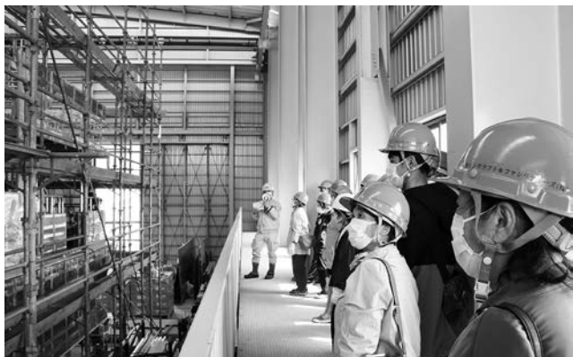
参加者は今しか見られない建造中の船体に釘付けでした
