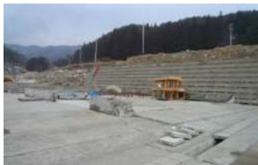
【石浜ボイル加工場被災状況写真】
