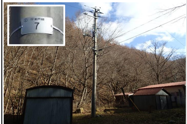
放水地点最寄りの高圧配電柱(平津戸線7)
