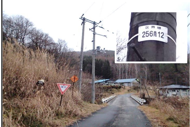
放水地点最寄りの高圧配電柱(区界線256南12)
