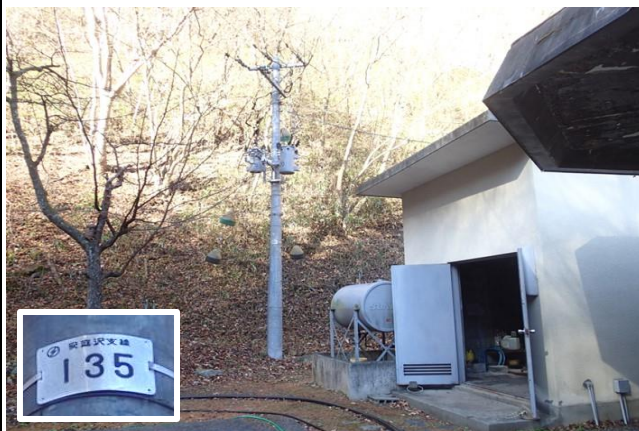
放水地点最寄りの高圧配電柱(安庭沢支線135)
