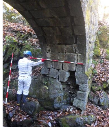
水路橋の老朽化状況(左岸側)
