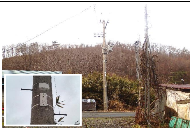
放水地点最寄りの高圧配電柱(NTT東17左3)
