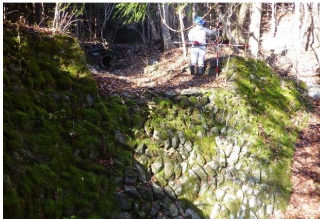
支川をサイホンで通過している。
