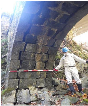
水路橋の老朽化状況(右岸側)
