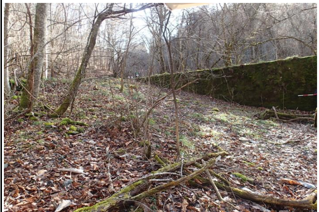
治山施設右岸側の林道への摺り付けはよい
