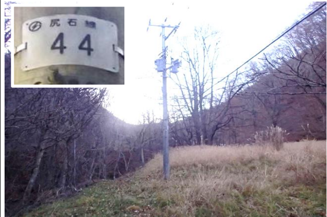
放水地点最寄りの高圧配電柱(尻石線44)
