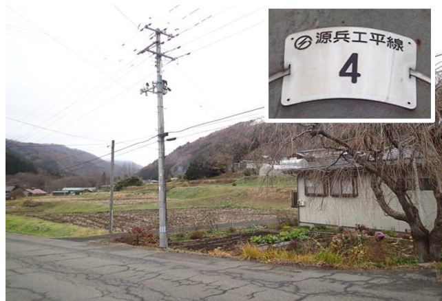
放水地点最寄りの高圧配電柱(源兵工平線4)
