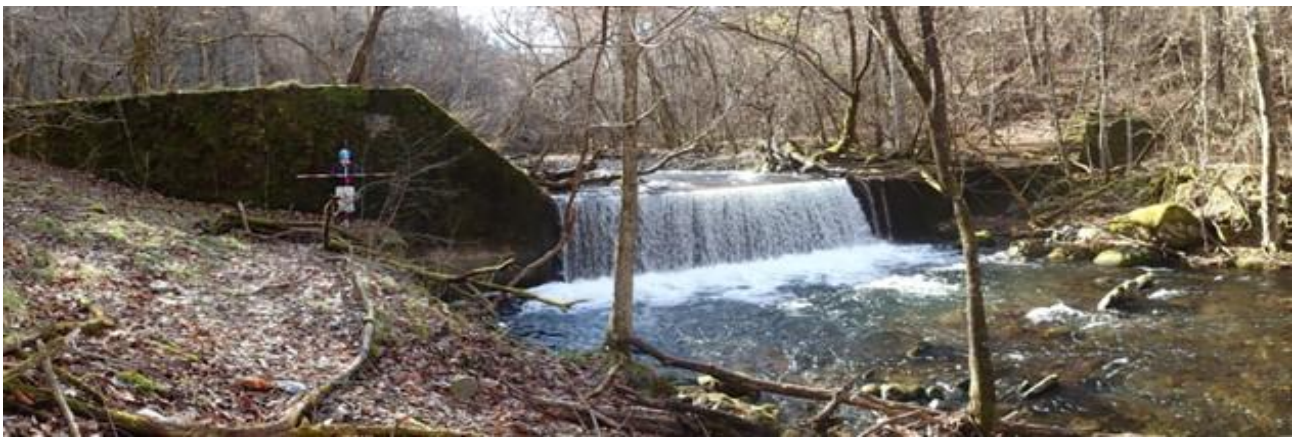
取水地正面(既設堰堤、昭和56年度吉部沢床固、三陸北部森林管理署)
