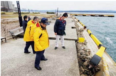
岩手県派遣職員と七尾市和倉温泉地区の護岸被害を視察する山本市長(中央)
