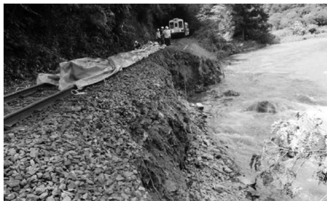
三陸鉄道「佐羽根駅～田老駅間」線路路肩の洗掘
