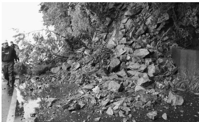
市道津軽石熊の平線（太田浜～白浜）の土砂崩れ、倒木
