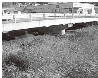
氾濫の原因となる堆積土砂
