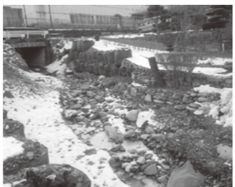
早期復旧が望まれる台風第10号による損壊箇所
