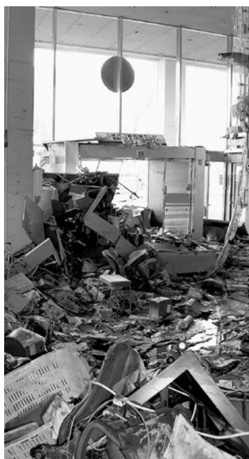
東日本大震災により被災した旧本庁舎の市民ホール（平成23年3月撮影）
