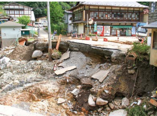
台風10号による被害（和井内・平成28年8月）
