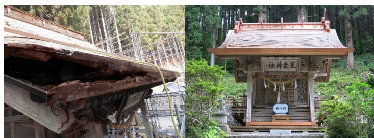
軒先の腐食状況（修復前）
