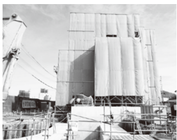
完成が待たれる藤原雨水ポンプ場
