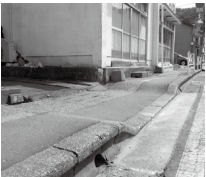
段差のきつい歩道
