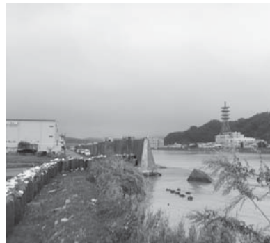
水が流入し壊れていた堤防
