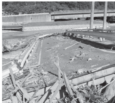
台風10号で落橋した刈屋川の橋
