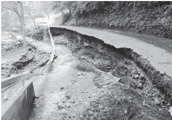
洗掘され損壊した市道
