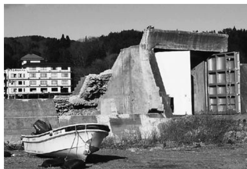
破壊された水門
