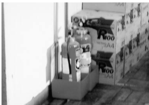
初期消火に不可欠な消火器
