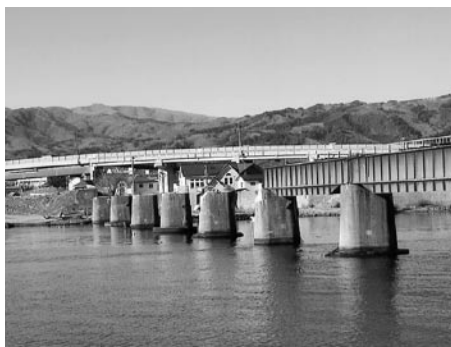
破壊された鉄橋（宮古橋）
