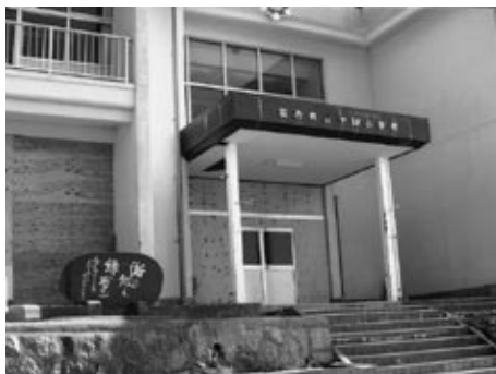
被災した千鵜小学校
