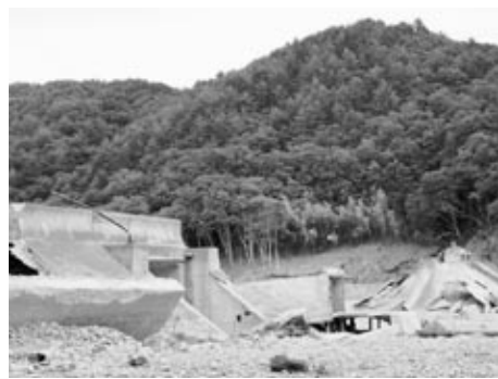
破壊された防潮堤（女遊戸）
