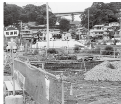
復興交付金事業で施行されている 鯨ヶ崎地区の土地区画整理事業
