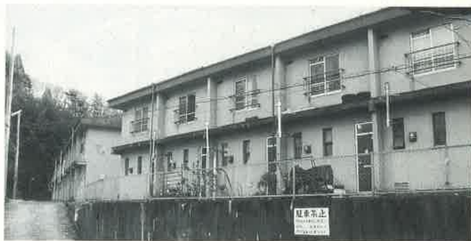
老朽化が進む市営住宅
