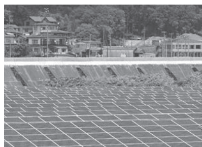
既存の田老地区太陽光発電設備
