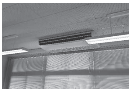
普通教室に設置している空調設備
