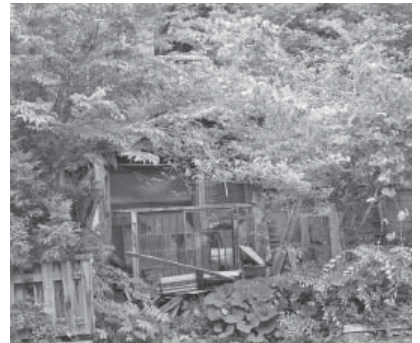
倒壊の恐れがある空き家
