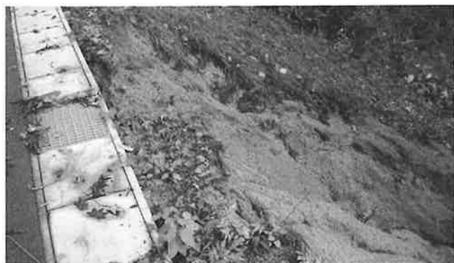
台風10号による法面崩落
