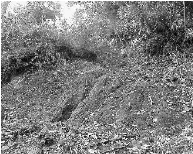
崎山貝塚縄文の森公園斜面崩落
