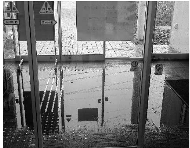
施設エントランス浸水状況
