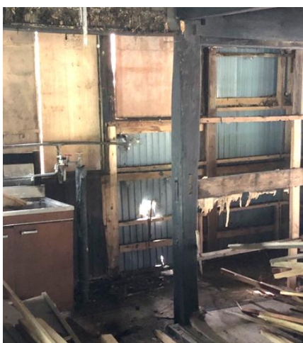
外壁の貫通した穴
