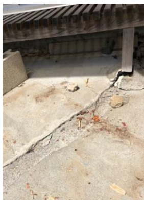
不同沈下や柱の傾斜
