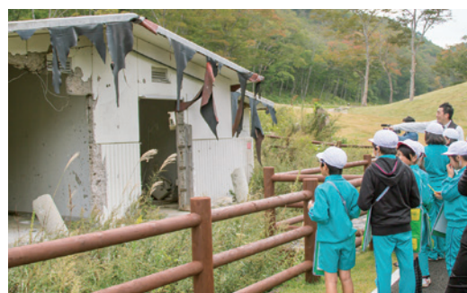
震災で破壊されたトイレ
